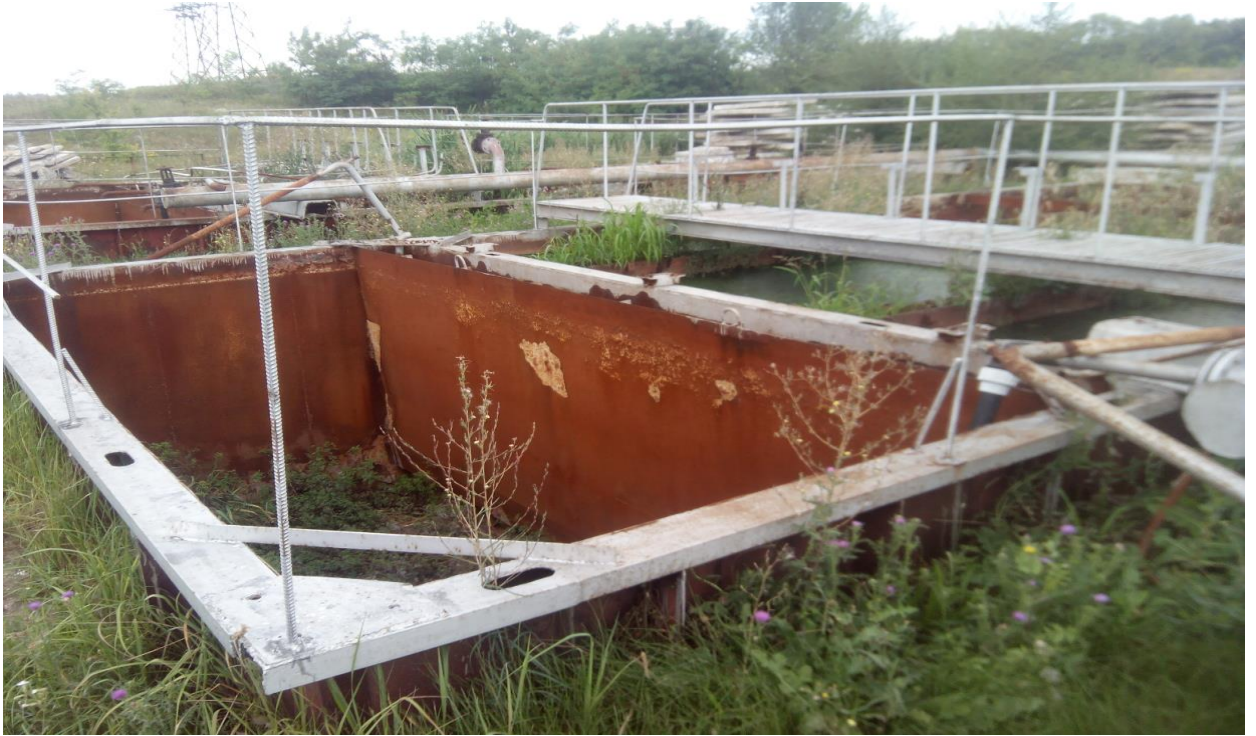
Рисунок 1. Очистные сооружения п. Вейделевка
