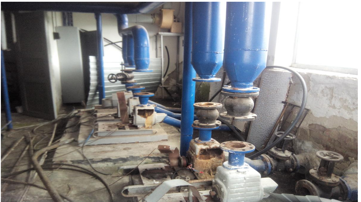
Рисунок 2. Оборудование очистных сооружений п. Вейделевка
